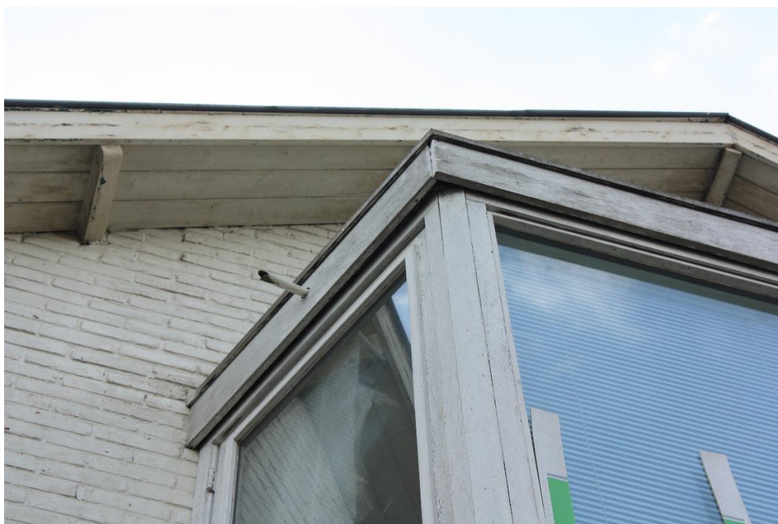
Figuur 4: Ruimte onder de betimmering aan de noordzijde van het pand
