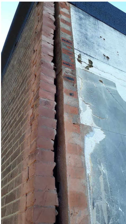
Opengebroken spouwmuur in elektriciteitshuisje
