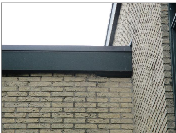
Afbeelding 5.3 | Door ontbrekende bakstenen is de spouw toegankelijk (gebouw nummer 20).
