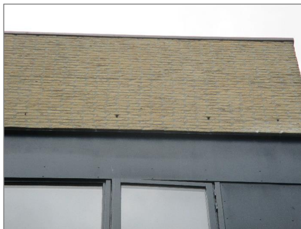
Afbeelding 5.2 | Open stootvoegen in gebouw nummer 20A.
