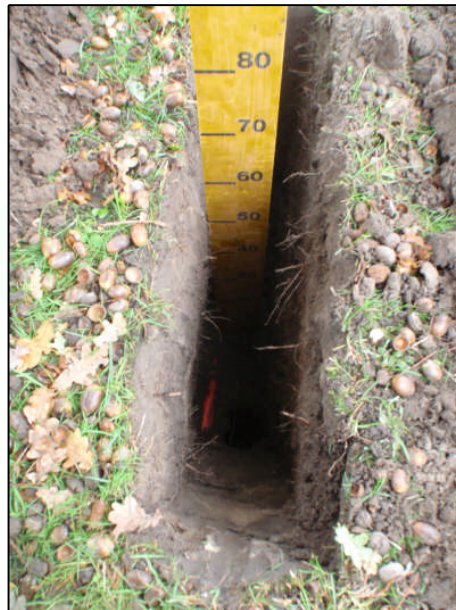
Bij deze profielsleuf binnen een kroonprojectie zijn kabels aangetroffen.
