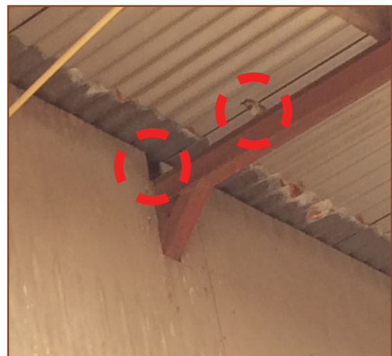
Afb. 2.5: Huismus en nestingang in één van de gebouwen behorend tot de bouwmarkt.
