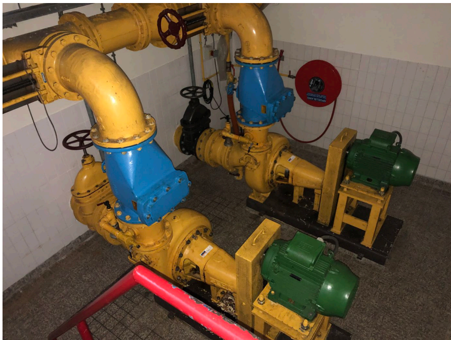
Foto B5.2. Twee waterpompen, gemiddeld debiet 500 m³/uur.
