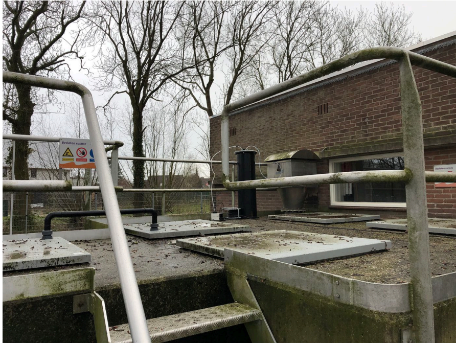
Foto B5.1. Ontvangspot rioolwater met luchtdichte deksels en aflat met filter.
