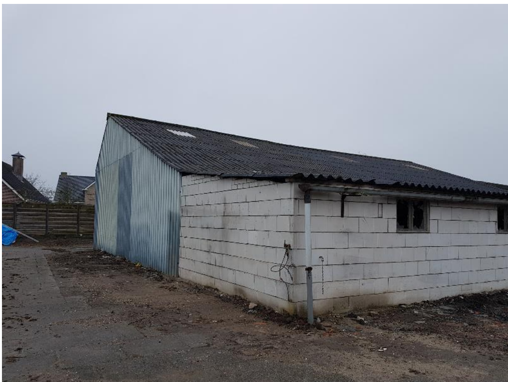
Figuur 2 De gedeeltelijk te saneren schuur aan de zuidwestzijde van het plangebied.
