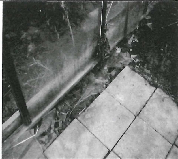
toelichting foto 1: glas wat uitgesloten van inspectie is
