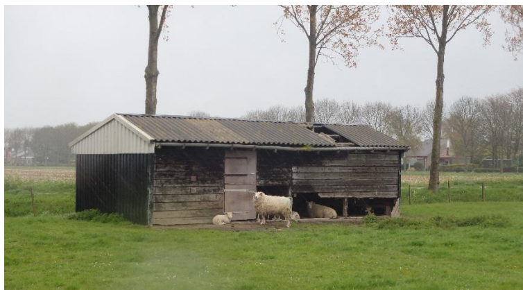
Figuur 4: beschadigde schapenschuur.
