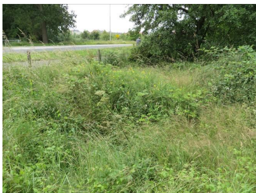
Foto 18: De tunnel onder de Huurlingsedam is vrijwel dichtgegroeid en is gesitueerd op een onlogische plek. Door het graven van een greppel vanuit deze tunnel naar de bestaande greppel zal de tunnel weer kunnen functioneren.
