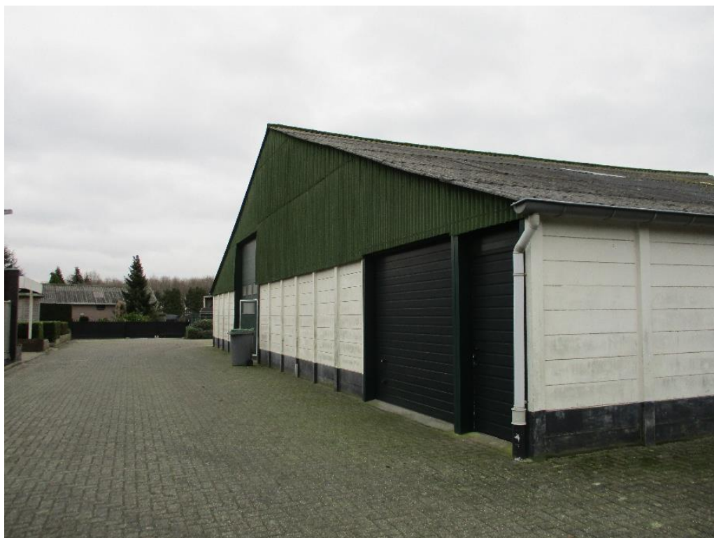
Figuur 2 De kopgevel van de loods is vanaf ca. 2 meter hoogte bekleed met metalen golfplaten
