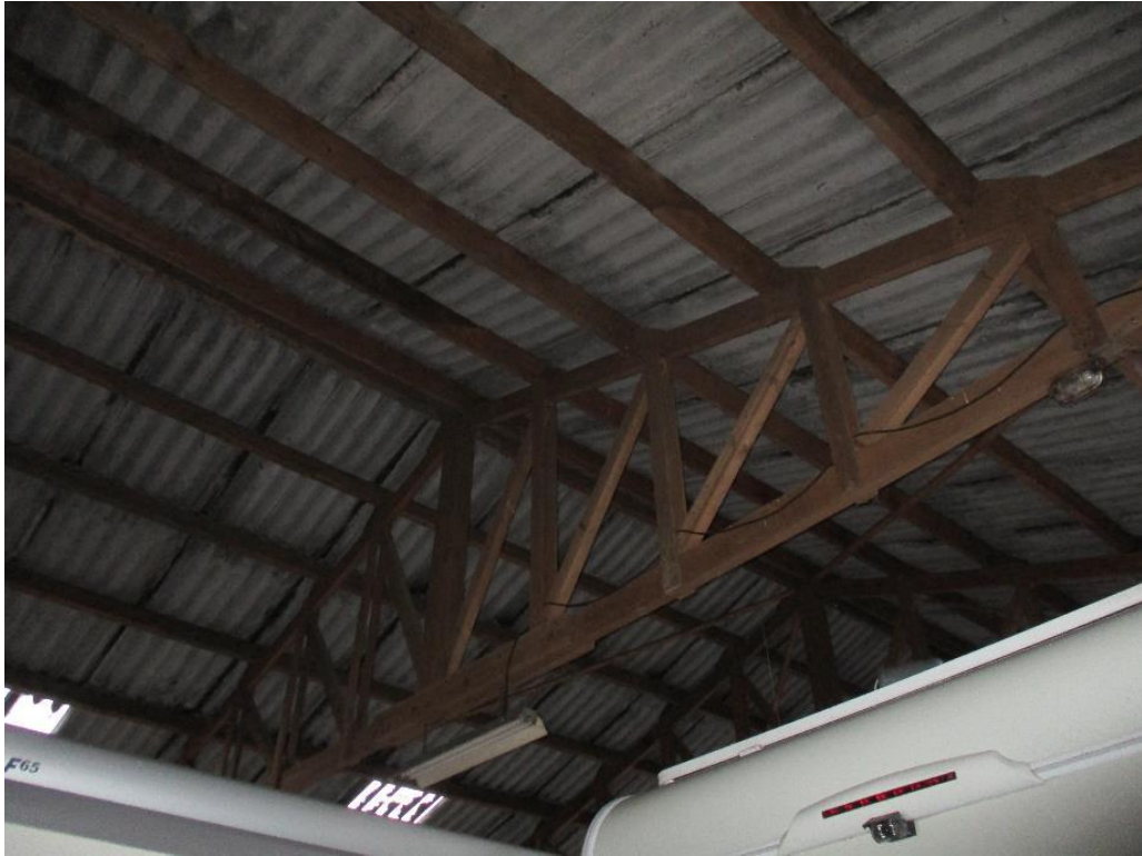
Figuur 3 Het dak is grotendeels niet geïsoleerd en heeft geen dakbeschoot
