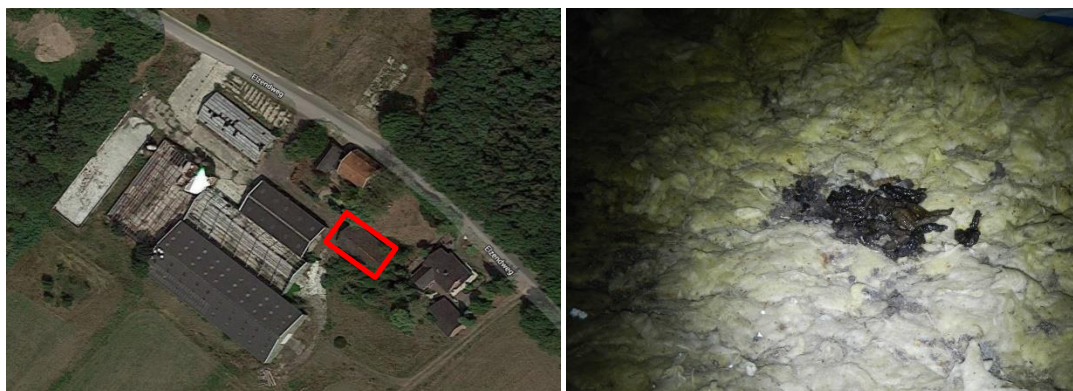
Figuur 8. Steenmarterpoep op de zolder van een van de gebouwen.
