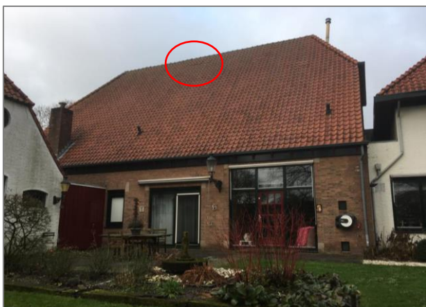
Afbeelding 4.4 | Losliggende dakpannen geschikt als invliegopening voor vleermuizen.
