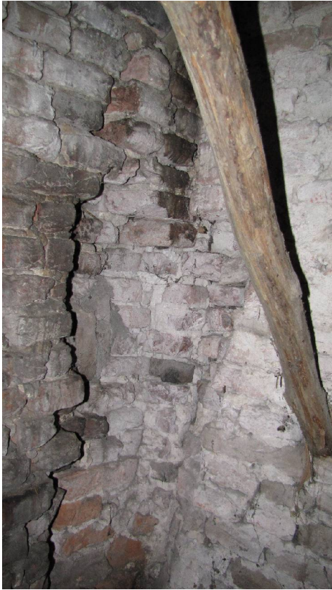
Afbeelding 3. Scheur aan de binnenzijde van een buitenmuur, geschikt voor overwinterende vleermuizen.
