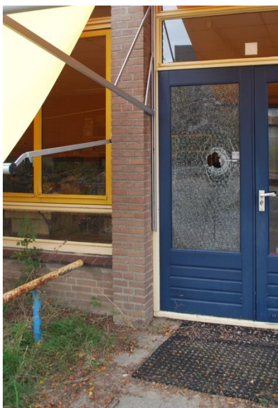
Gat in deur zuidzijde
