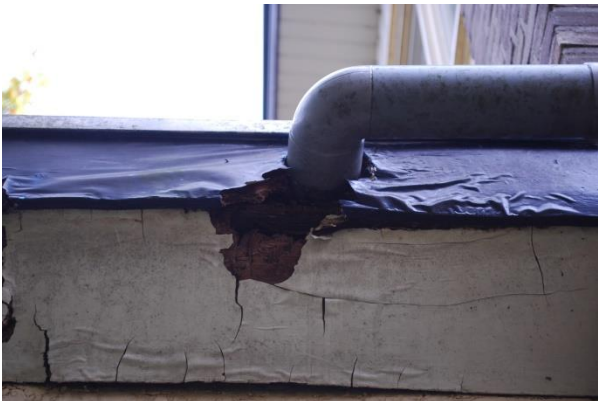
Gat in betimmering achterzijde entree noordoost kant
