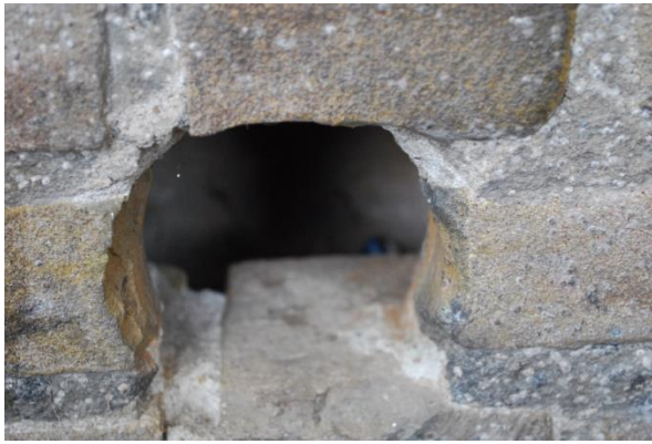
Gat links van entree noordoost kant, soorgelijk gat op 1 m onder dakrand hoge gebouwdeel
