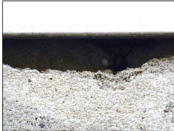
Figuur 2. Eén van de gaten onder de dakstrip.
