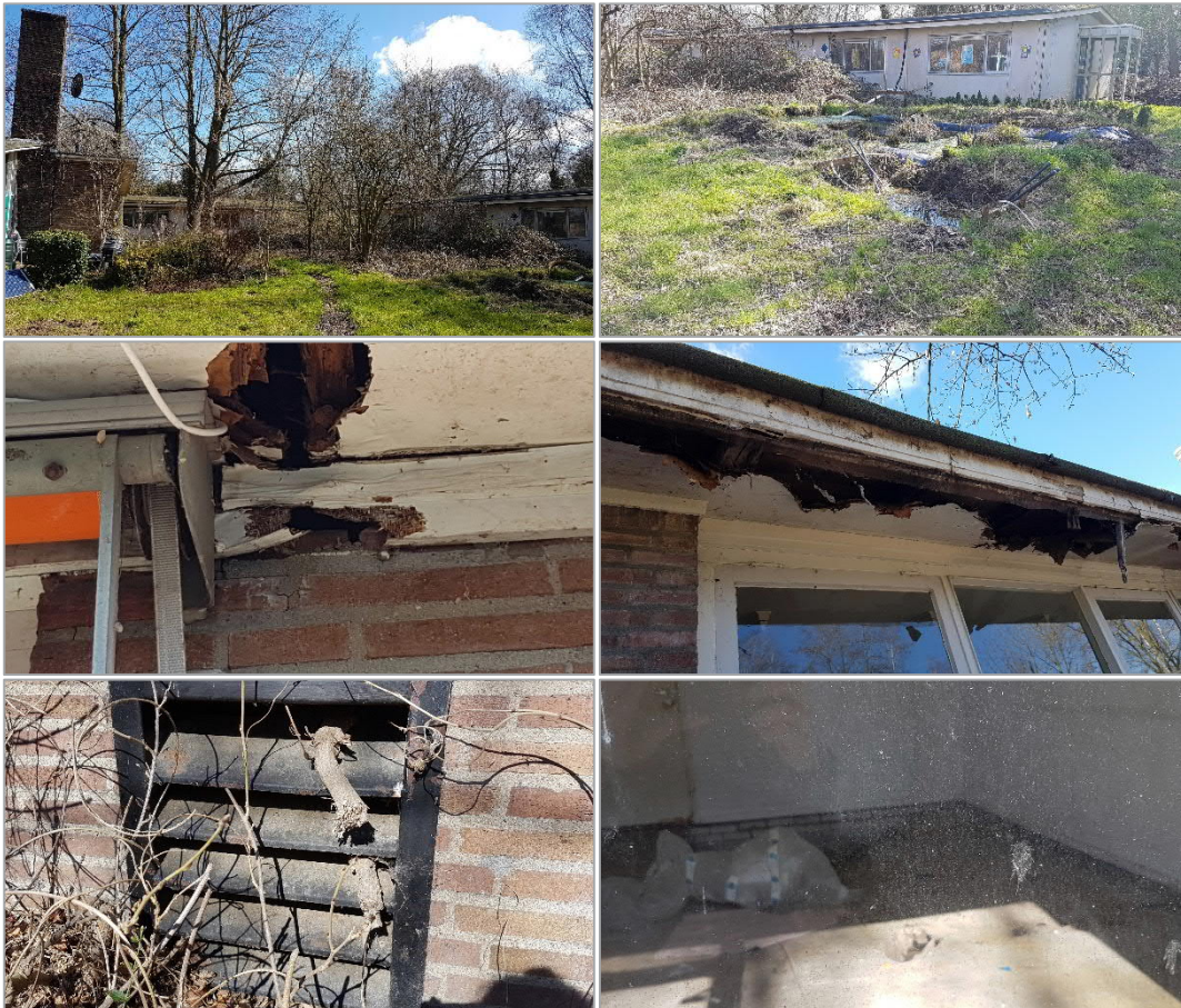
Figuur 3.9 'Rommel'hoekje, rotte daklijsten en ingestorte vloer op de begaande grond.
