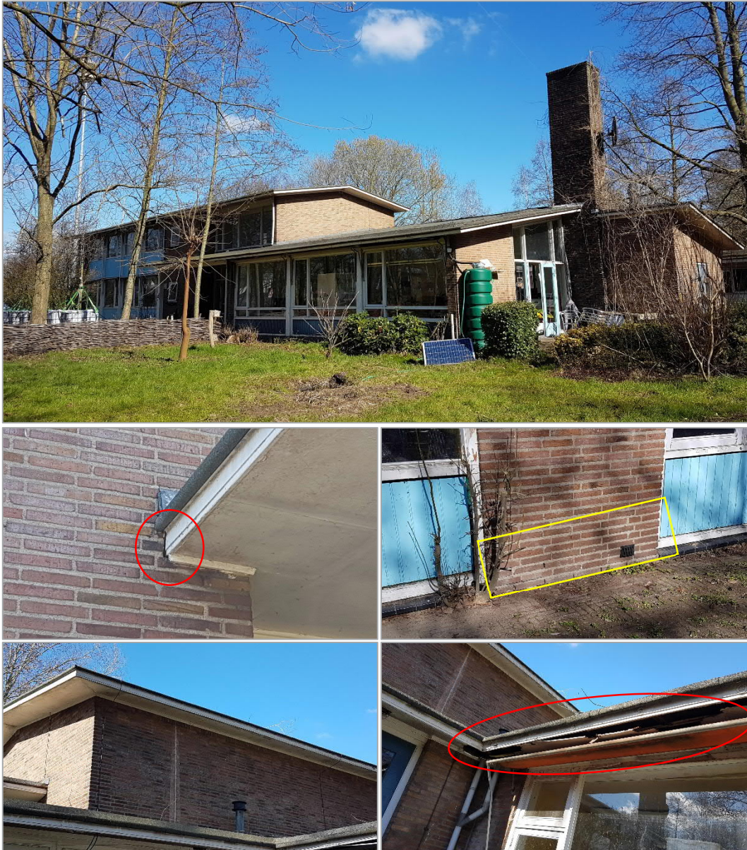
Figuur 3.5 Gebouw Plant-e (Mansholtlaan nr. 4): kieren / rotte beplating (rood) en open stootvoegen aan de onderzijde (geel).
