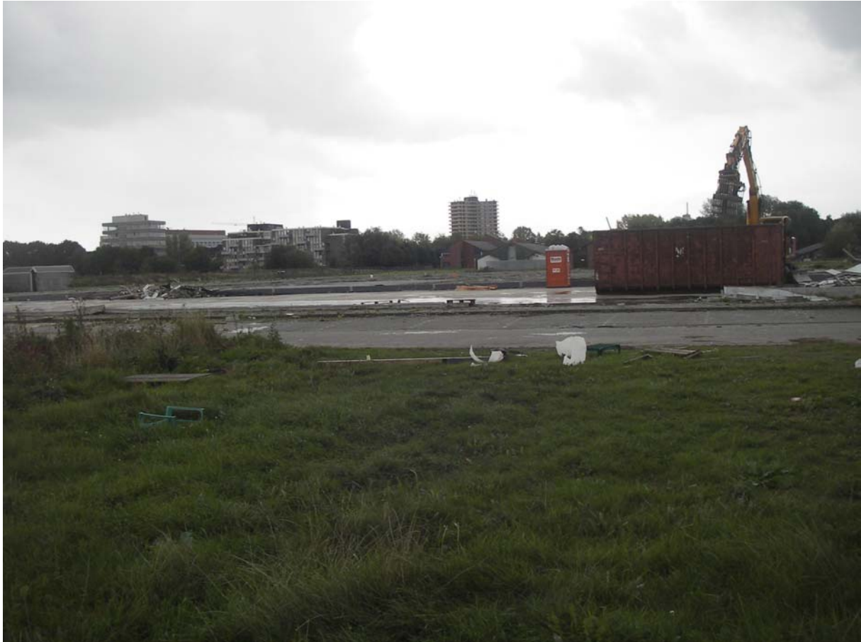
Figuur 2: Sloopwerkzaamheden op het noordoostelijke gedeelte van het plangebied gezien vanuit het noorden.
