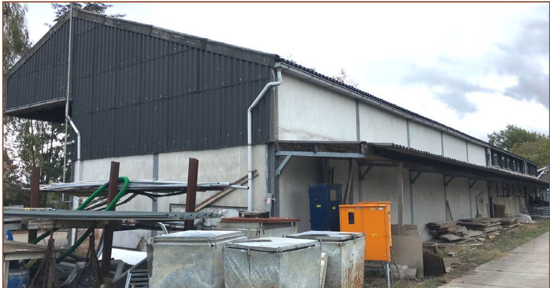
Afb. 2.1: De te slopen schuur. De schuur is ongeschikt als vaste rust- en verblijfplaats voor vleermuizen. Ook is de schuur ontoegankelijk voor vogels en zal daarom niet dienen als verblijfplaats van bijvoorbeeld Huismus.
