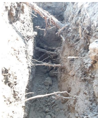
Afb. 32 Proefsleuf bij boom N35 toont aan dat er sprake is van redelijk intensieve beworteling met een wortel van 4 cm dikte op 40 cm. overige wortels hebben een diameter tot 2 cm.
