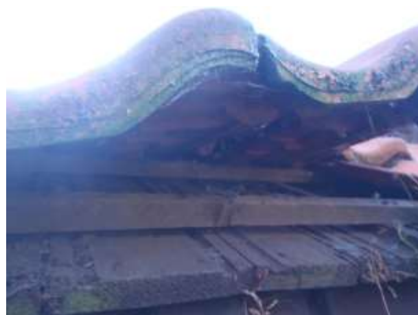
Foto 6, opgelichte pannen met daaronder de constructie van dakbeschot met panlatten
