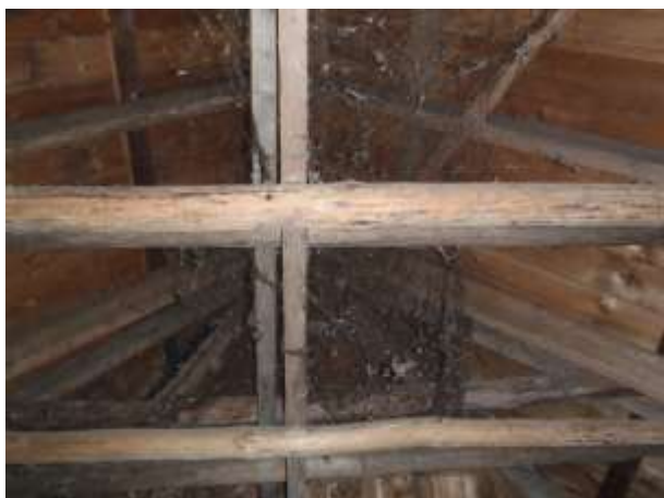
Foto 7 , de zolder met de dakconstructie en het vele spinrag in de nok van de zoldering.
