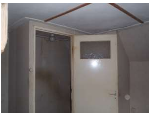
Foto 8 , slaapkamer op verdieping, zachtboard plafond is direct tegen de balklaag aangemaakt. Tussen de balken ligt isolatiemateriaal aan de bovenzijde bevinden zich geen vloerplanken.
