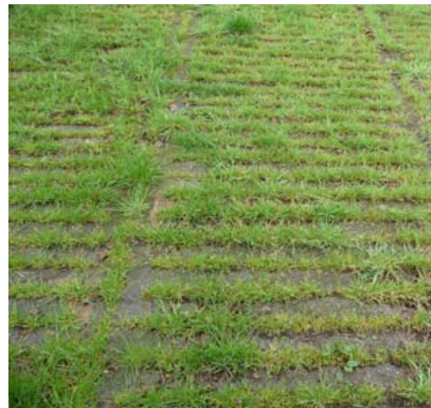
Oude betonnen mestroosters
