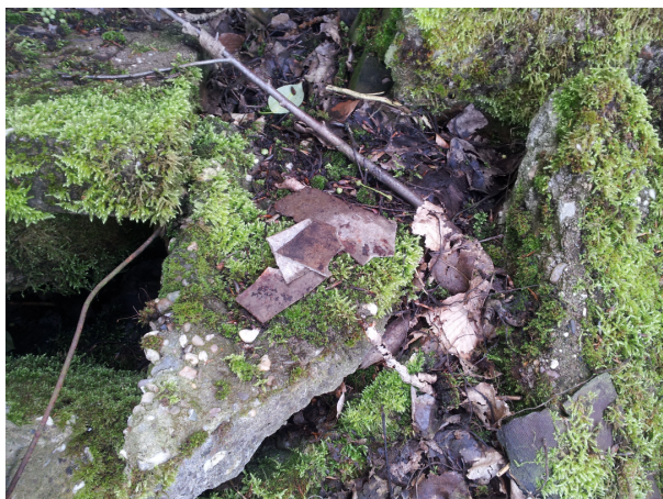
Foto 8: asbest op maaiveld (gevonden tussen puin en beton)
