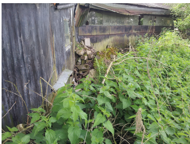
Foto 9: berg puin en beton op maaiveld achter de ligboxenstal
