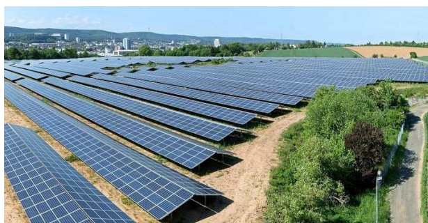
Een zonneveld oostwest aangelegd
