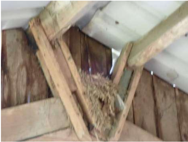
Foto 6: links, merelnest onder het dak van de schuilhut
