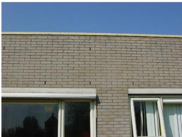
Foto 6, open stoot voegen aan de zuidzijde van het complex. De spouw is voorzien van polystyreenplaten
