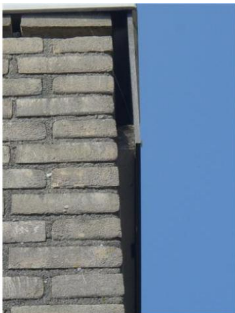
Foto 7, opening in de gevelplaten, vooral op de hoeken zijn er mogelijkheden voor vleermuizen om in te vliegen.
