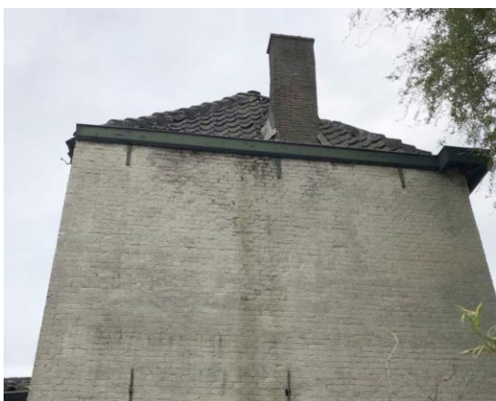
Afbeelding 4. Noordgevel van het woonhuis, met losliggende dakpannen en loszittend loodslab.
