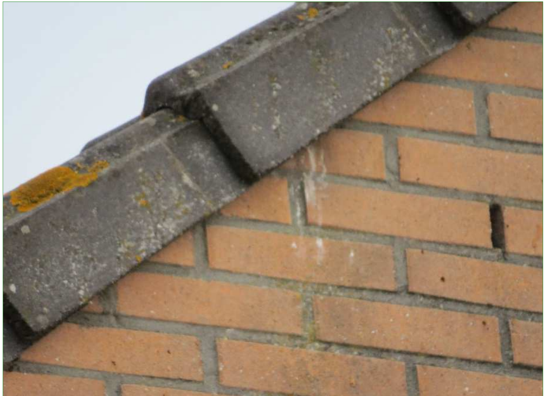
Typische invliegplek van Gierzwaluw onder een eind nokvorst (voorbeeldfoto, niet in plangebied). Aan de hand van sporen op de muur zijn invlieglocaties op te sporen.
