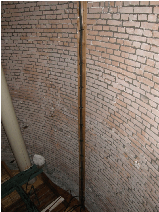
Plank waarachter een overwinterende Gewone dwergvleermuis is aangetroffen
