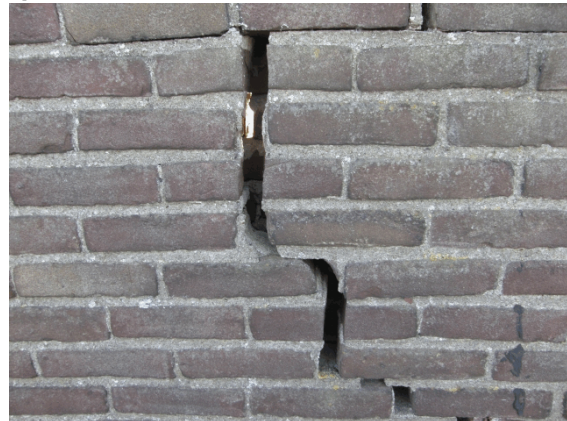
Scheur in de buitenmuur met toegang tot de spouwruimte.
