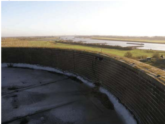
Op het dak is in de muur een scheur te zien.
