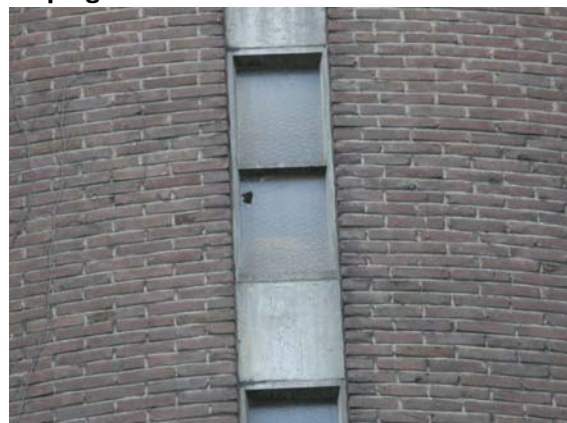
Raam met gebroken ruit op de eerste verdieping.
