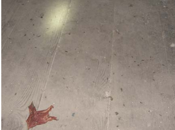
Uitwerpselen van de Gewone dwergvleermuis op de eerste verdieping.
