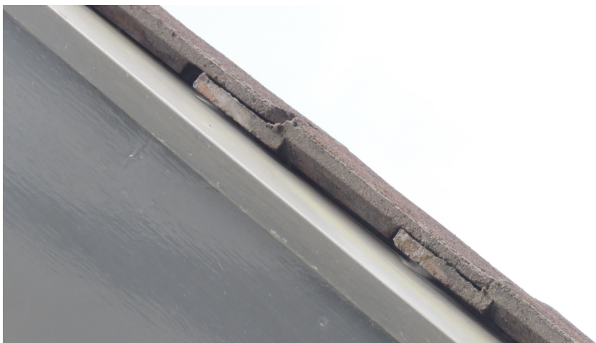
Afbeelding 9: Aan de kopse gevels sluiten de dakpannen zeer nauw op de dakrand.
