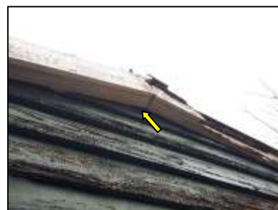
Figuur 17. Ruimte achter betimmering waar vleermuizen onder kunnen kruipen.
