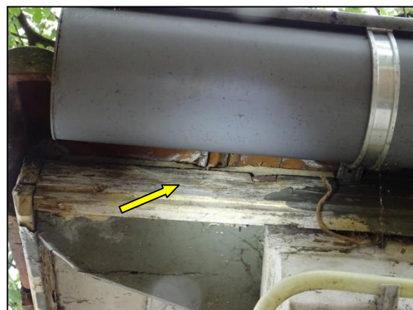
Figuur 10. Ruimtes tussen regenpijp, dakpannen en dakbeschoot.
