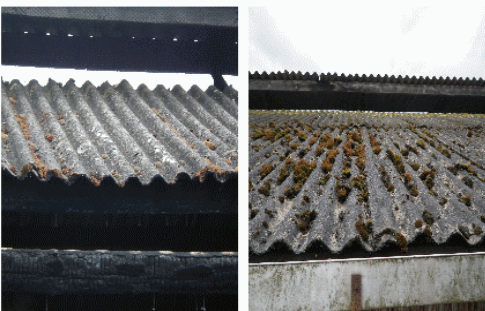
foto 7: Golfplaten (zeer slecht) blijven op de schuur aanwezig.
