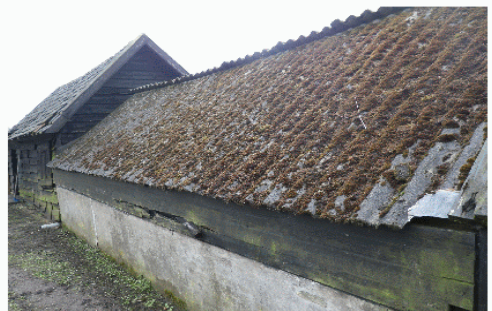
foto 8: Asbestverdachte golfplaten op schuur van buren.
