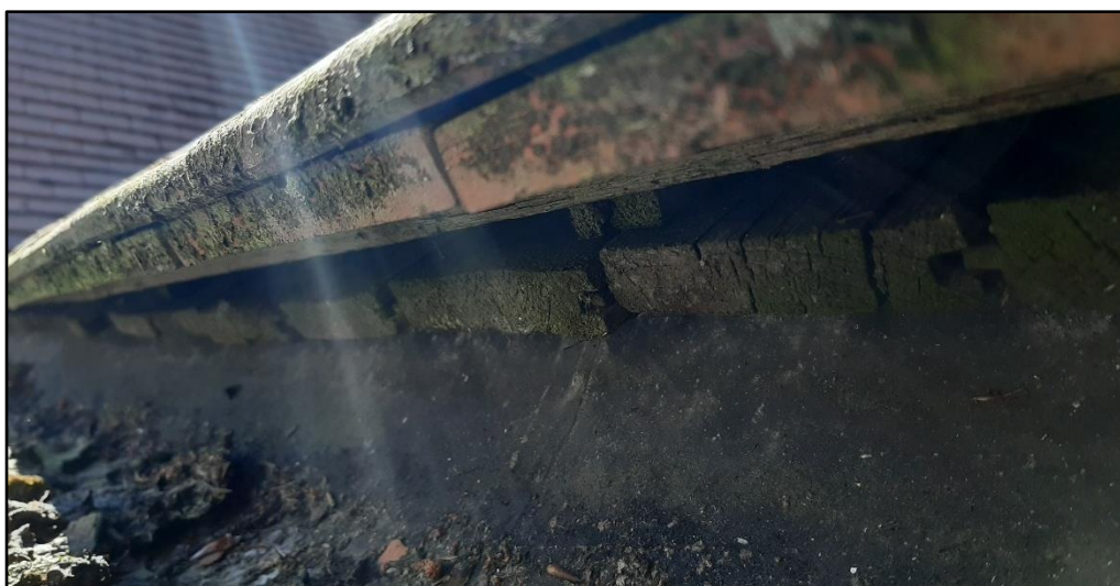
Figuur 6 De dakpannen op de woning sluiten te nauw aan op de panlatten en hebben een platte vorm, waardoor deze geen mogelijkheden bieden voor huismussen om er te nestelen.
