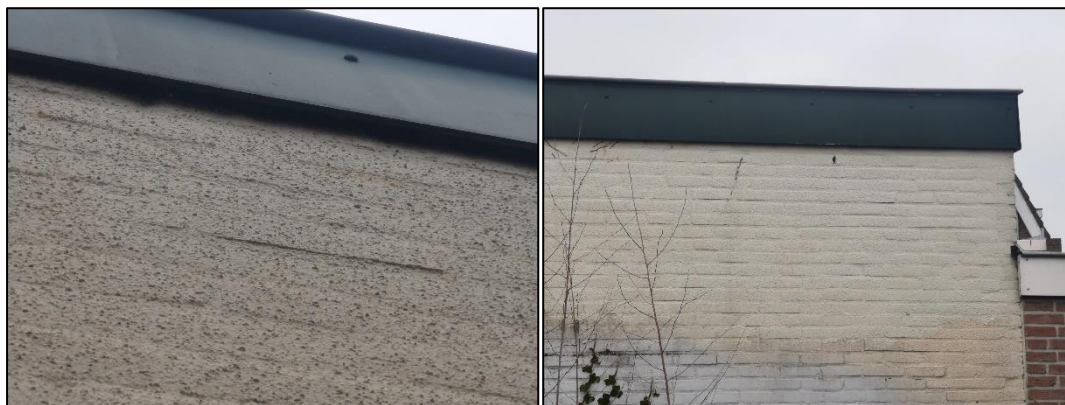
Figuur 6.1(links): Impressie van de daklijst die niet overal goed op de gevel aansluit; Figuur 6.2 (rechts): Open stootvoeg aan de achterzijde van het plangebied.
