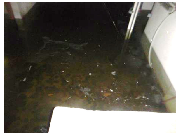
Water in kelder voormalig horecapand
