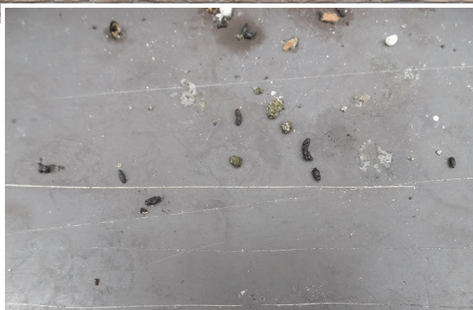
Uitwerpselen vleermuizen op de vensterbank
