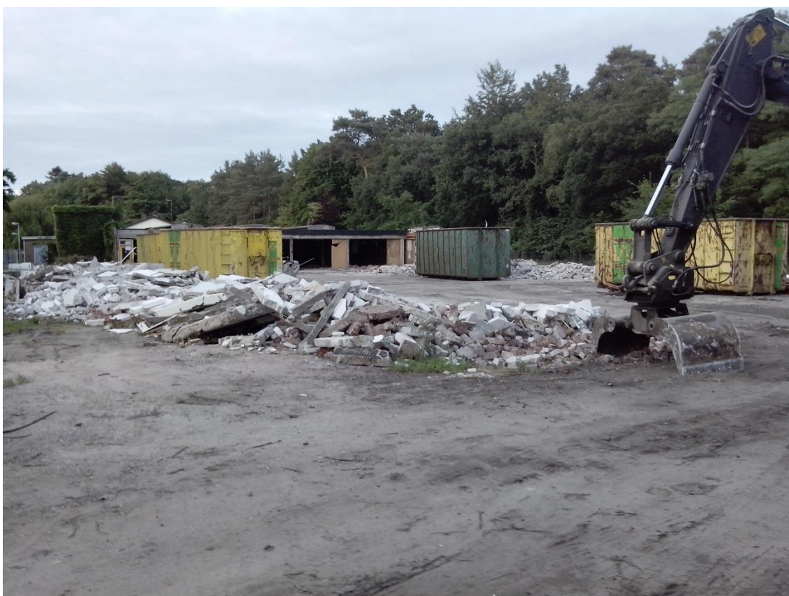
Figuur 8. Het pand in het zuiden van het plangebied, kort na de sloop.
