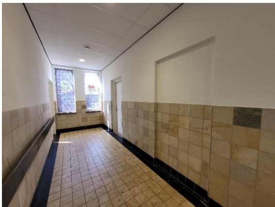
De oorspronkelijke doorgang van de zitkamer van ruimte 0.18 werd omstreeks 2015 dichtgezet. De doorgang naar de bijbehorende slaapkamer werd geheel vernieuwd.
