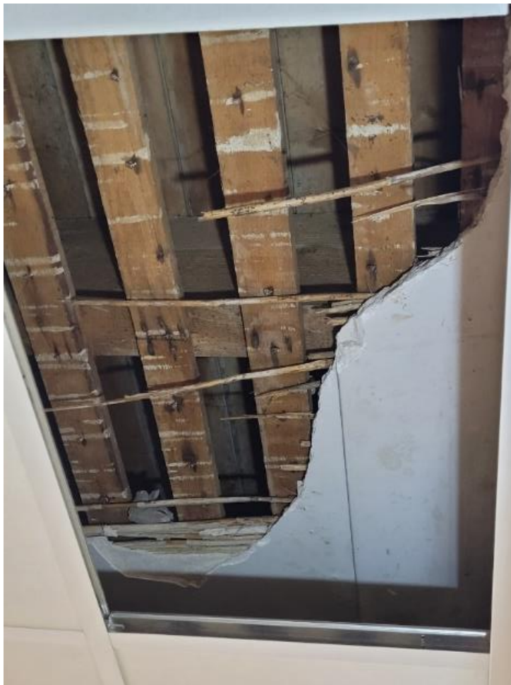
Oorspronkelijk stuc op riet plafond achter het systeemplatenplafond ter hoogte van het trappenhuis. Doordat een gedeelte is verdwenen, is de enkelvoudige balklaag van de zoldervloer zichtbaar.
