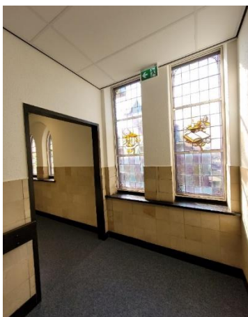
Originele glas-in-lood ramen aan het einde van de gang en aansluitende gang van de rechter zijvleugel.
