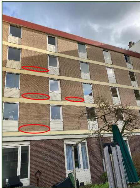
Fig. 2.17 Woonzorgcentrum diverse bredere stootvoegen, eigenlijk over het gehele pand verspreid (Bron: FF Solutions)
