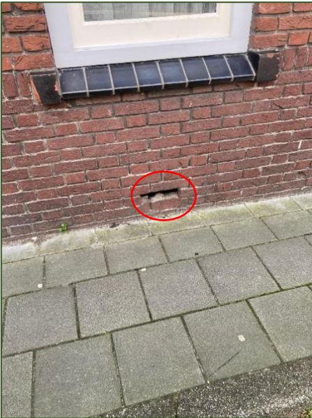
Fig. 2.7 Ventilatie opening zonder rooster zusterhuis (Bron: FF Solutions)
