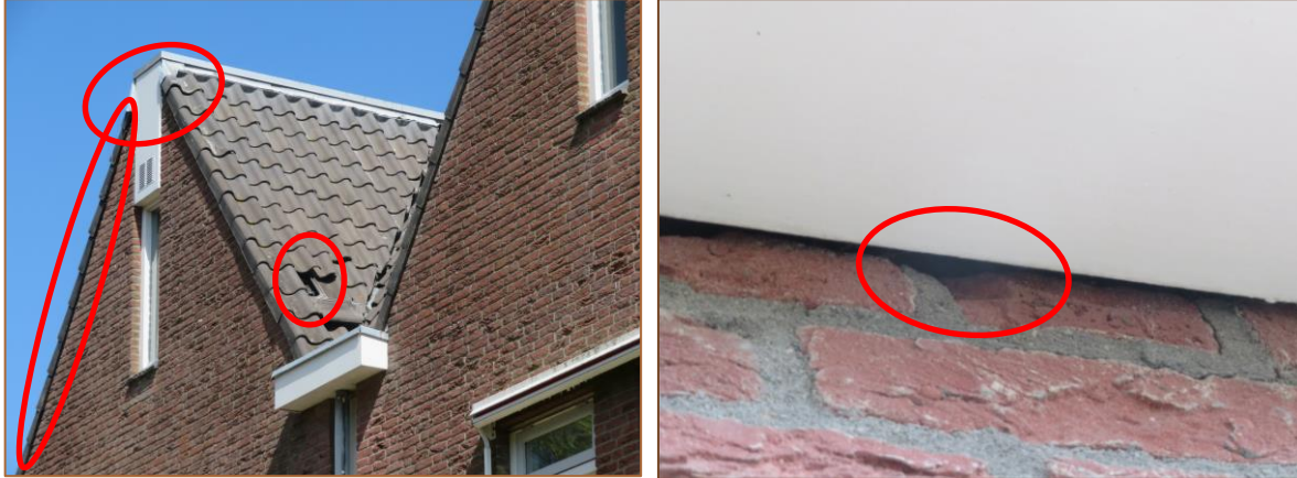
Foto's 5 en 6: Voorbeelden van kieren die toegang bieden tot potentiële verblijfplaatsen voor gebouwbewonende vleermuizen in bebouwing van Spoorstraat 2 (foto's: R. Top).
