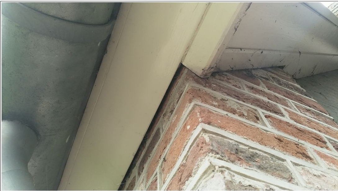
De betimmering aan de onderzijde van de dakgoot van de paardenstal heeft kieren welke geschikt zijn als potentiële verblijfplaats voor gebouwbewonende vlermuizen. Foto: M de Vries | Ecoresult B.V.
