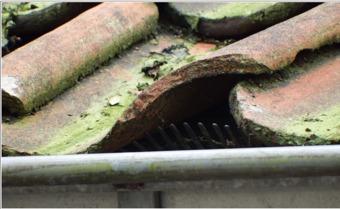
Op enkele plaatsen is het vogelschroot onder de dakpannen verzakt waardoor openingen ontstaan onder de eerste rij dakpannen welke geschikt zijn als vast rust- en verblijfplaats voor huismussen. Foto: M de Vries | Ecoresult B.V.
