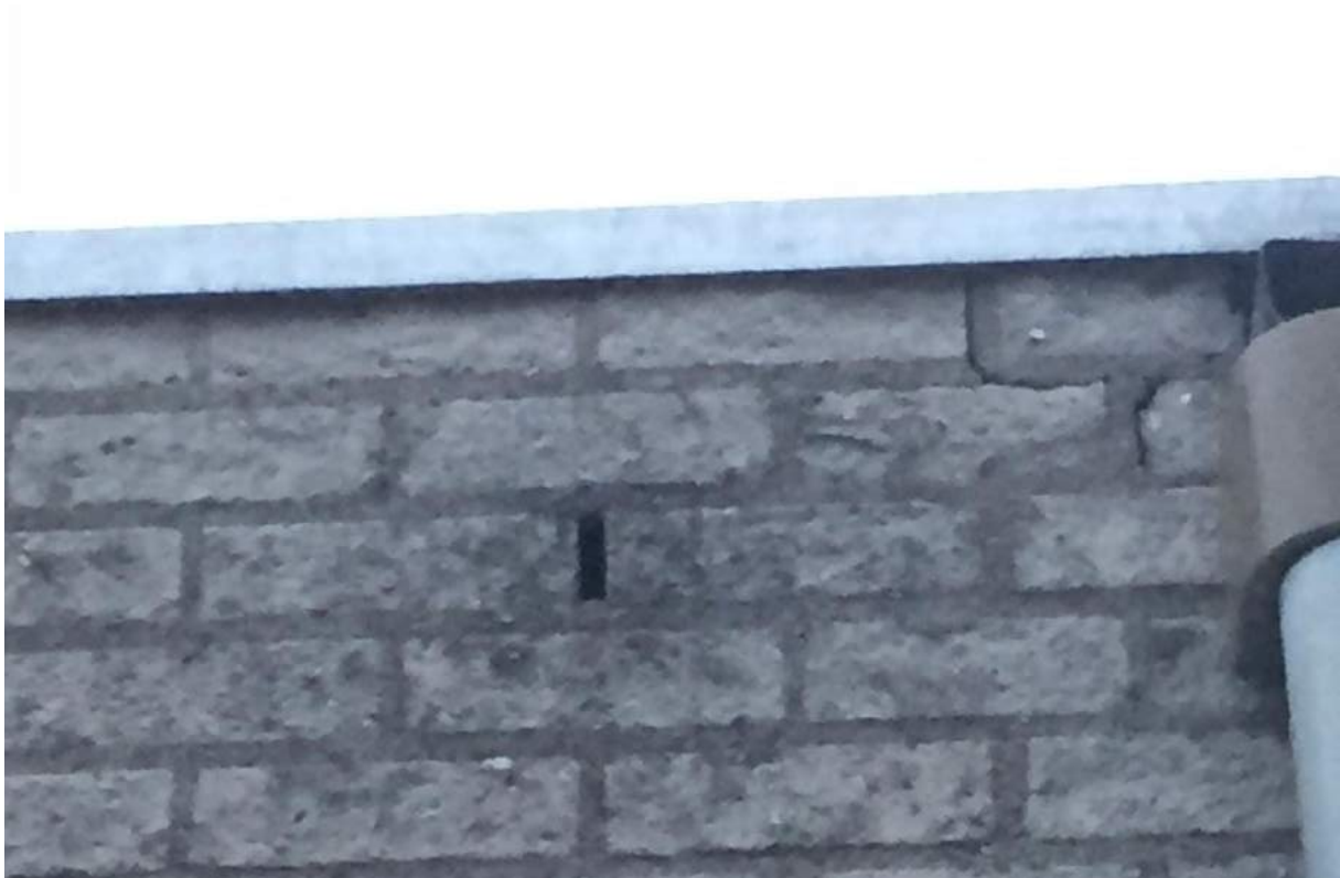
Figuur 3. Open stootvoeg in het westelijke deel van de zuidoostgevel van het winkelpand. Hier bevond zich een verblijf van tenminste twee gewone dwergvleermuizen. De grijze vlekken in een soort ring rond de open voeg zijn een indicatie dat dit verblijf geregeld gebruikt wordt.
