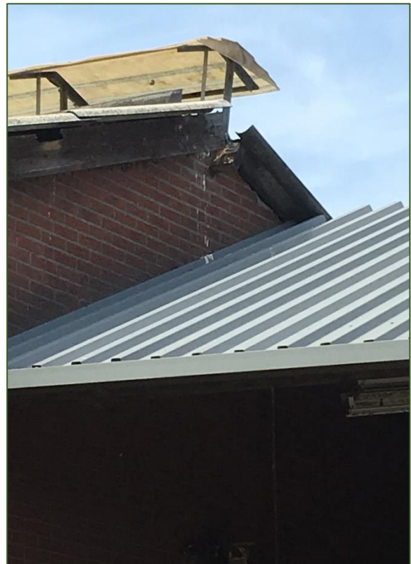
Buitenzijde nok ventilatie koeienstal binnen projectlocatie (bron: FF Solutions)
