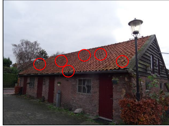
Fig. 2.3 Te behouden schuur, met enkele gaten bij dakpannen omcirkeld (bron: FF Solutions)
