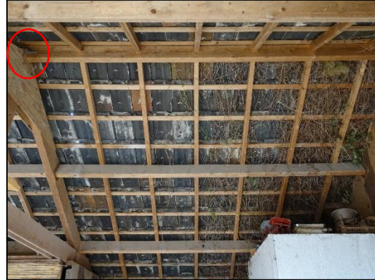
Fig. 2.11 Binnenzijde dak gebouw nr. 4, oud zwaluwnest rood omcirkeld (bron: FF Solutions)
