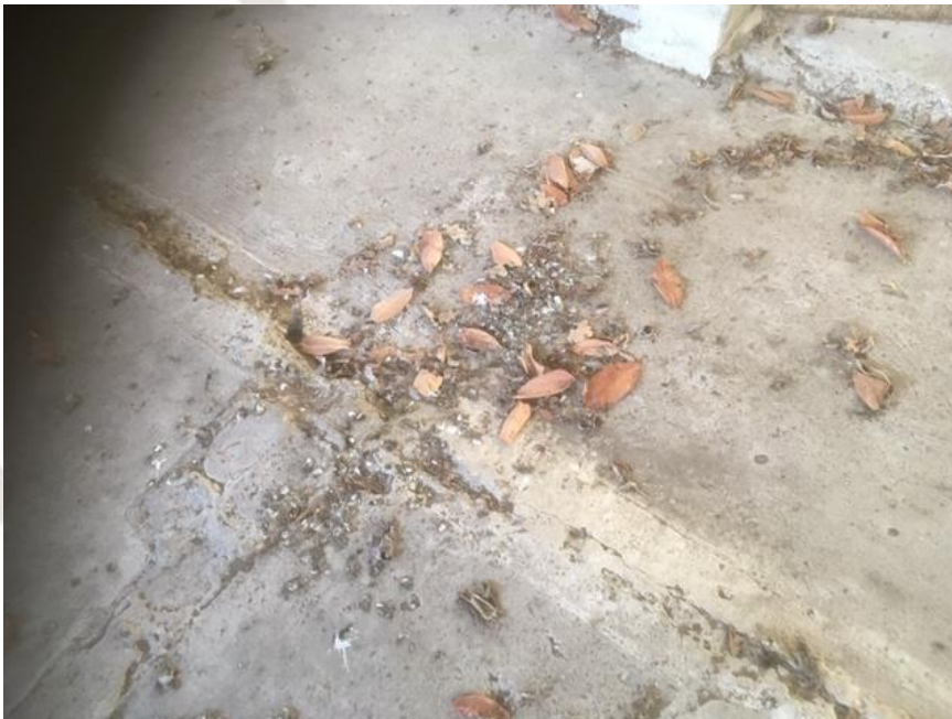
De vloer bevat sporen van uitwerpselen (Bron: FF Solutions)
