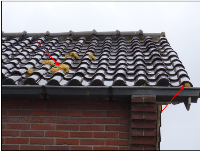
Figuur 12. De woning is ongeschikt gemaakt voor huismus en gierzwaluw d.m.v. het dichtmaken van alle openingen m.b.v. purschuim.
