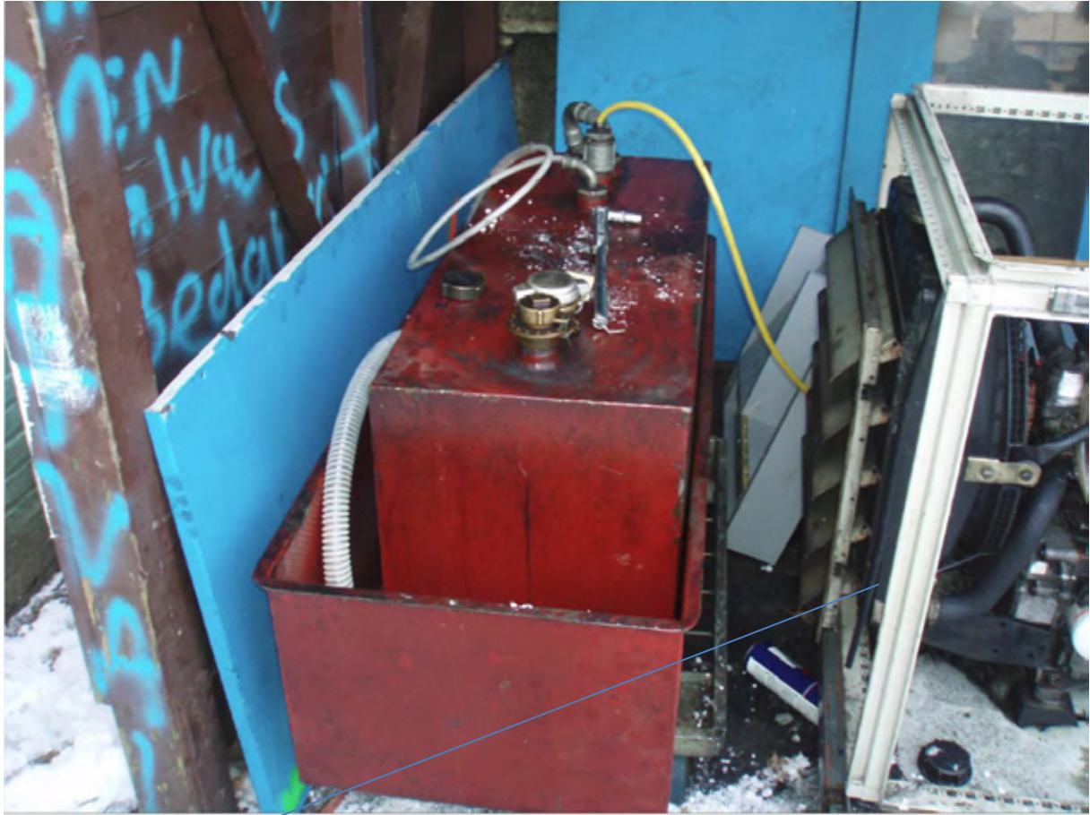
Aggregaat onder afdak met daarbij opslag van olie.
