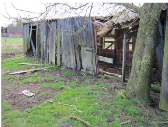
Foto 6: Achterzijde deels ingestorte schuur
