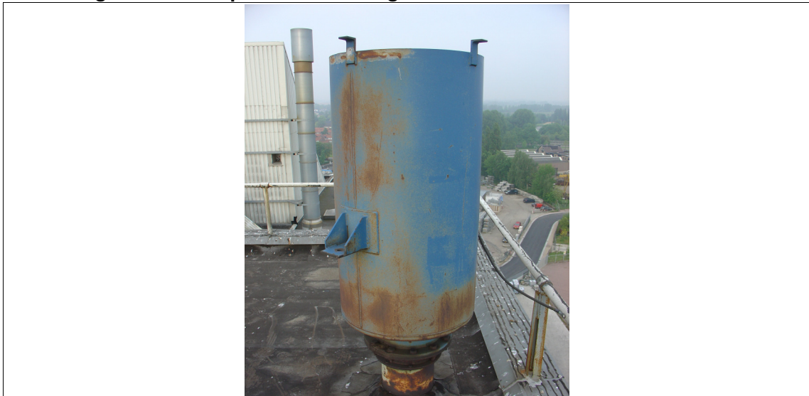
Afbeelding 3.1. Emissiepunt uitblaas zuiginstallatie
